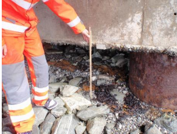
Figur 7.10: Bilde av 70+cm setning under landkar på Lysøybrua (Foto: BRUTUS, Statens Vegvesen)
