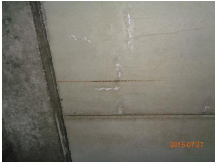
Figur 7.12: Bilde av underside plate på Semskaelv lille (Foto: BRUTUS, Statens Vegvesen)
